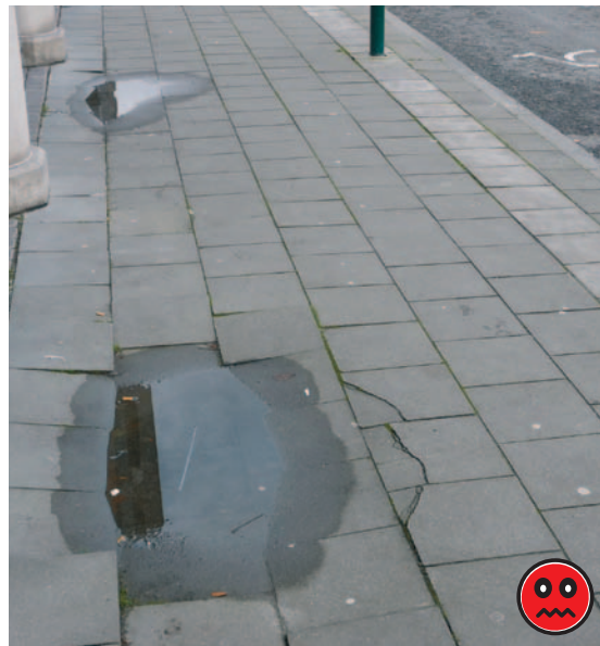
Stilstaand water als gevolg van slechte waterafvoer
