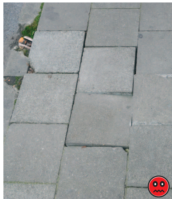
Losliggende tegels tasten de stabiliteit van de verharding aan
