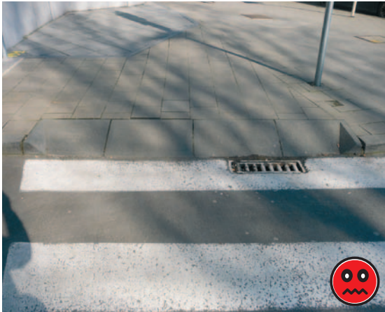
Ontoegankelijke overgang rijbaan-looproute (niet-conforme hellingen en kolk in de oversteekplaats)
