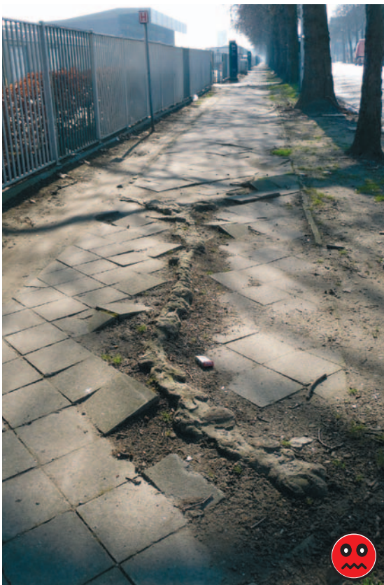
Beschadigde trottoirverharding door opstuwende boomwortels
