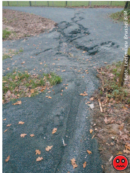
Uitspoeling van ongebonden materiaal
