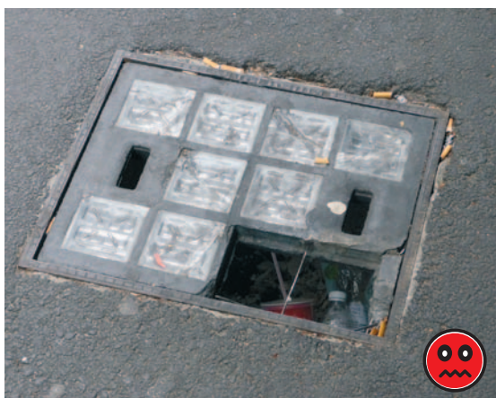
Een beschadigd deksel van ventilatieopeningen vormt een obstakel voor voetgangers
