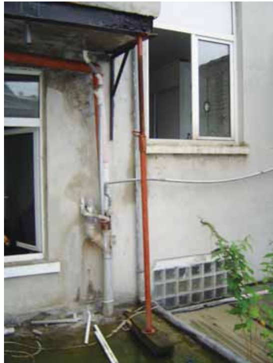
Het vooruitspringende metselwerk van de badkamer steunt enkel op een werfpaal die op het platte dak van de woning op de benedenverdieping rust.
