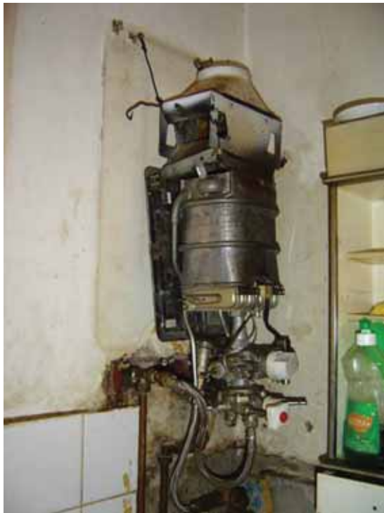
Dit toestel was tot het bezoek van de inspecteurs nog in gebruik...: het heeft geen afvoer en wordt bevestigd door een draad.
