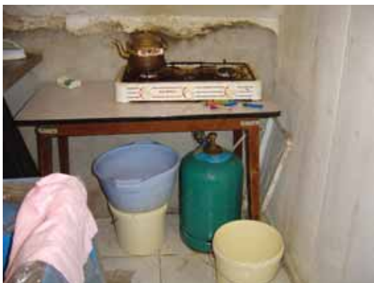
De huurder heeft enkel deze installatie om te koken en water te verwarmen.
