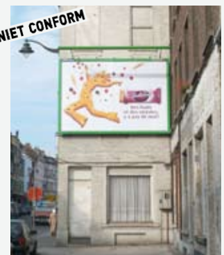
Niet-conforme reclame-inrichting op een zijgevel, op minder dan 0,50 m van de rand van de zijgevel; deze brengt de woonbaarheid in het gedrang door overlapping van de gevelopeningen.
