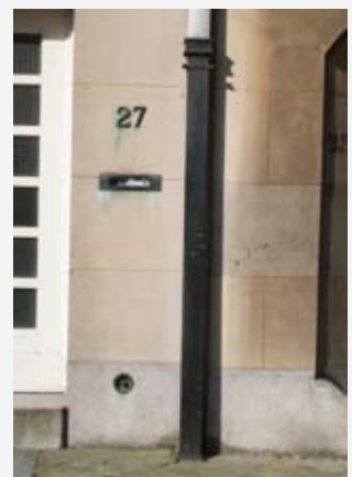
Regenpijp die uitsteekt op de gevel, voorzien van een uitloopbuis van minstens 1 meter hoog.
