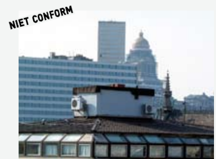
Fig. 10A: niet-conform dak: de technische verdieping is niet geïntegreerd in het dak.
