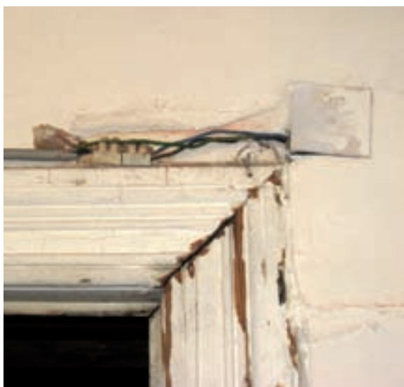
Uiterst gevaarlijke elektrische aansluitingen
