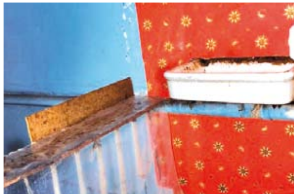
Gemeenschappelijke lavabo op de overloop, geen sifon en aansluiting op de regenwaterafvoer
