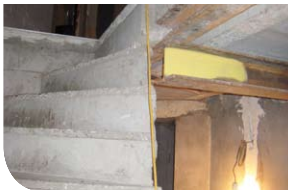
Boord van de tredes stuk, geen trapleuning = gevaarlijk
