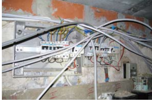
Elektriciteitsbord waaraan werd geprutst: bijzonder gevaarlijk
