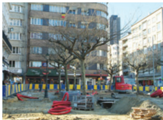
Rénovation de la place Saint-Josse et de son noyau commercial dans le cadre de l'accord de coopération Beliris.
