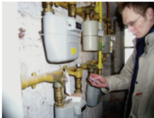
Dans le cadre des visites, vérification des compteurs de gaz.
