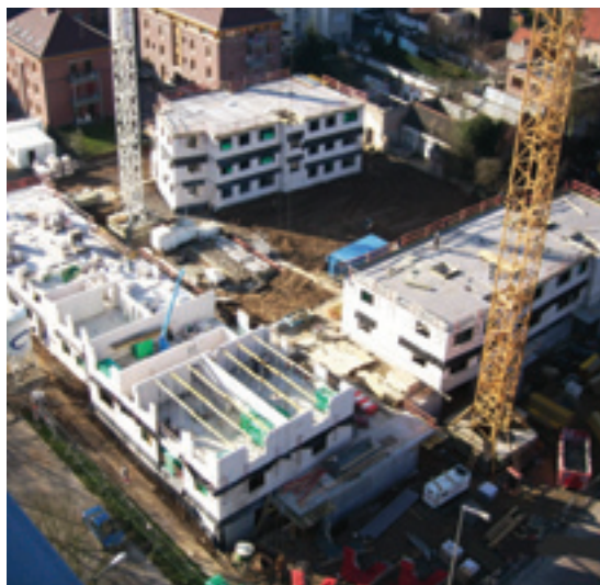
Construction de 65 logements rue Jules Lahaye (Jette) dans le cadre du Plan Régional du Logement.
