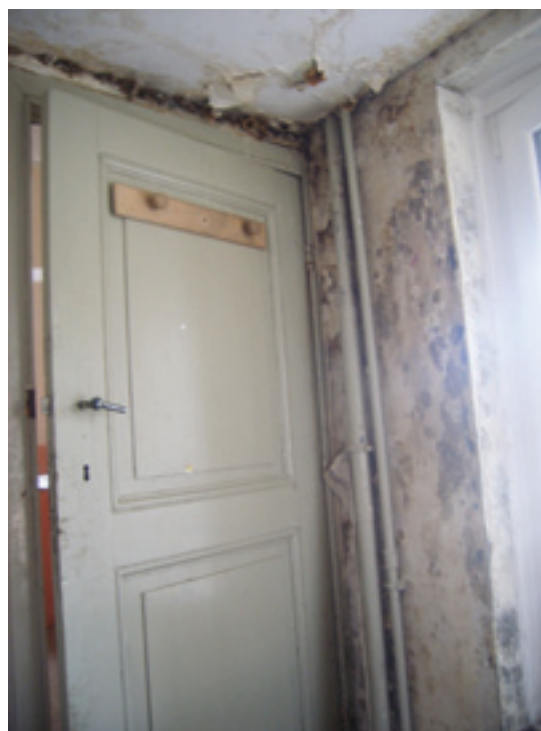
Avec de tels problèmes d'humidité, la santé et la salubrité des occupants n'est plus garantie!
